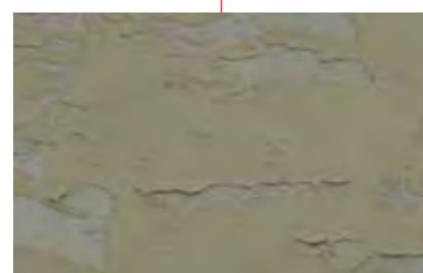
Vecchia pittura organica da asportare
